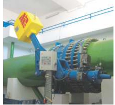
شیرهای سایز 1800 فشار 25 بار - نرمال باز کاربرد: شکستگی خط پروژه: خط آبرسانی در کشور الجزایر (مجری شرکت پرتغالی Efacec)
