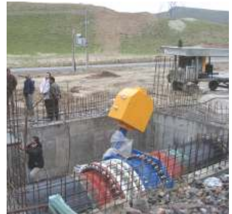
شیر سایز 1800 فشار 25 بار - نرمال باز کاربرد: کنترل پمپ و شکستگی خط پروژه: سد دوستی خراسان رضوی
