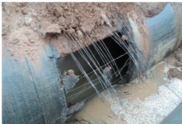
شکستگی لوله بتنی مسلح خط انتقال آب به منبع ذخیره گورت اصفهان
